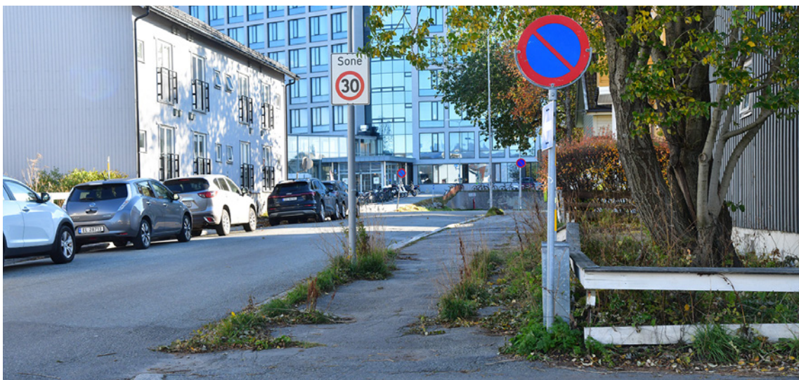
Nedslitt fortau ved Nordlandssykehuset.
